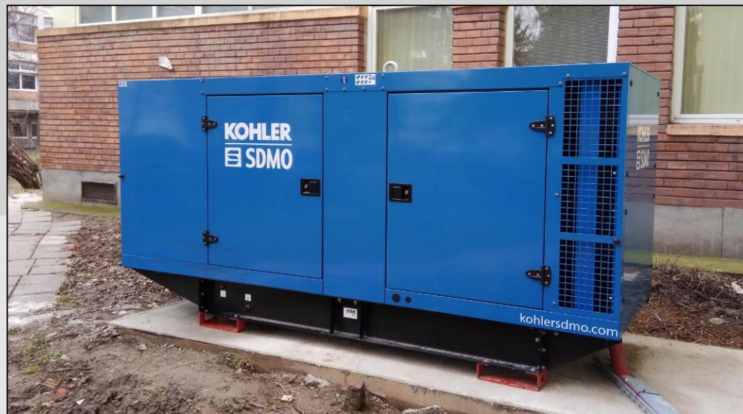
Echipele ale RoEdu utilizate în comun cu U.P.T. Grup electrogen de 120KVA, 96kW
